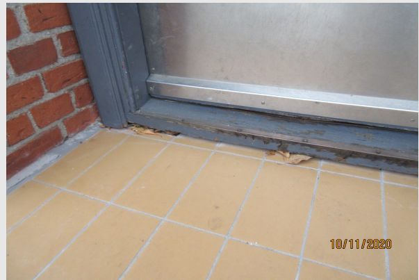
Skade i bundstykke.
