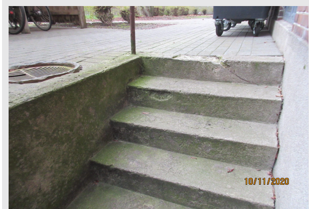
Kældertrappe, afskalning/revner i pudslag og beton.
