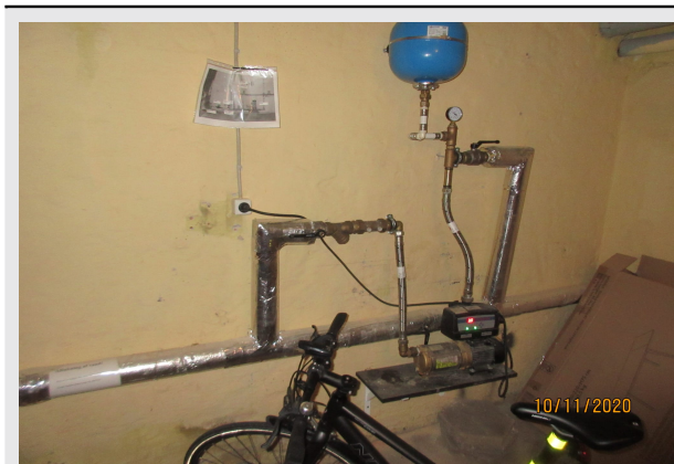
Teknikrum, kælder (trykpumpe).
