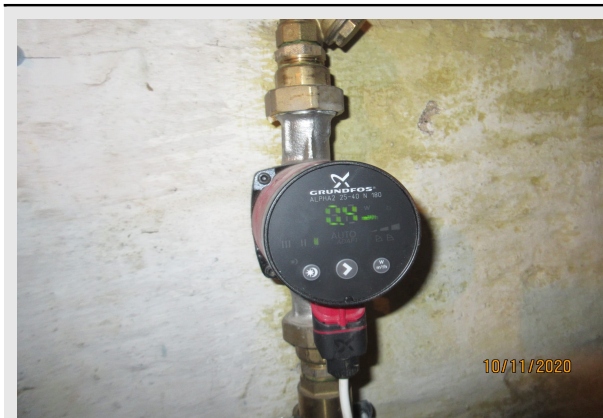
Teknikrum, kælder (cirkulationspumpe, brugsvand).
