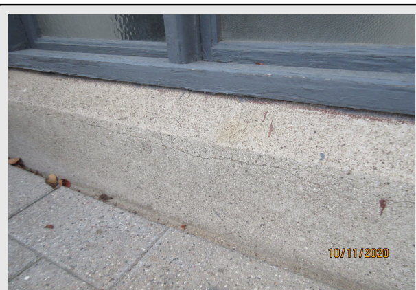
Sokkel, revnedannelse i puds mod Annasholmsgade.
