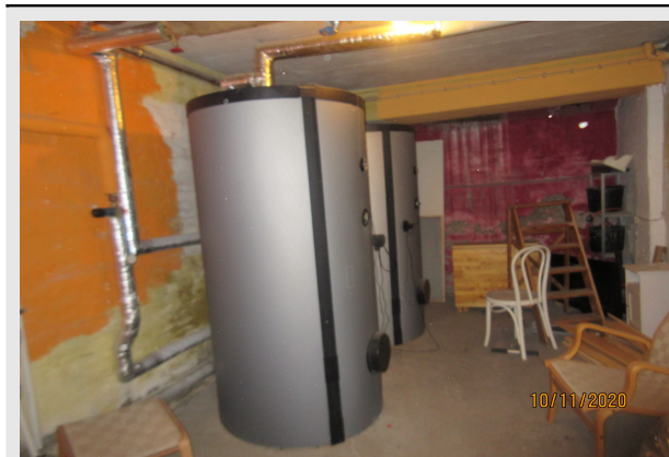
Teknikrum, kælder (varmtvandsbeholdere).
