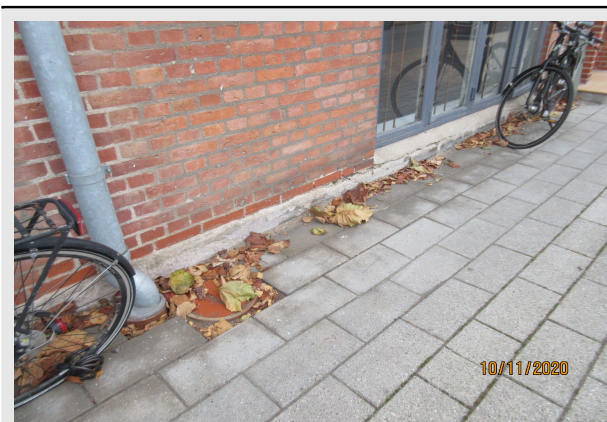
Sokkel, løst puds mod Henriettevej.
