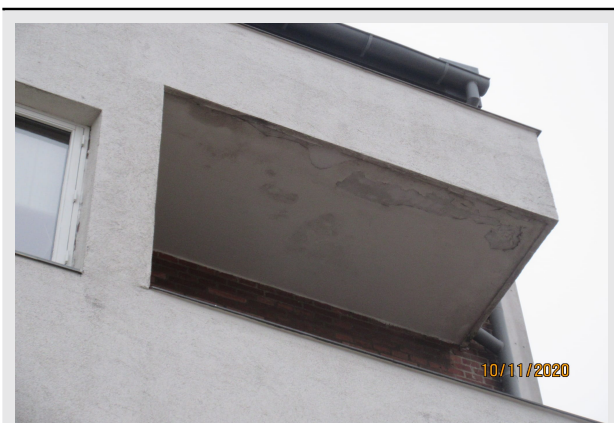
Afskalninger, underside af altanbund.
